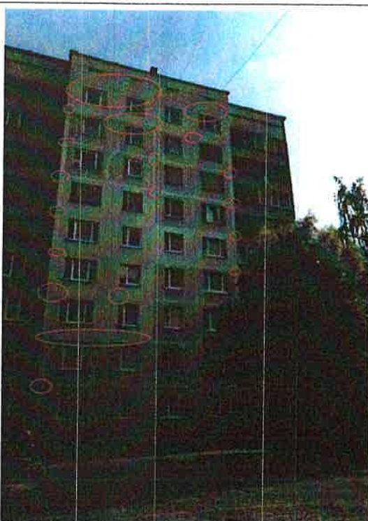
Bojātās starppaneļu šuvju vietas
