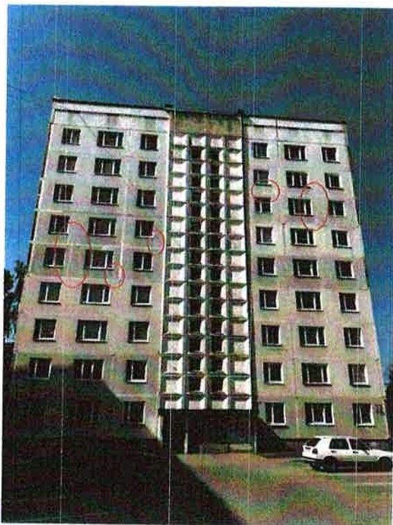
Aizdarinātās plaisas sienu paneļos ēkas priekšējā fasādē
