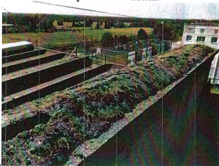
Plaisas, sūnojums uz ventilācijas kanālu betona nosegelementiem
